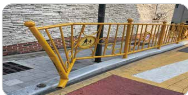
어린이보호구역 안전시설 파손
