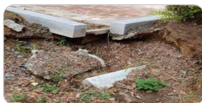
축제장 시설 파손
