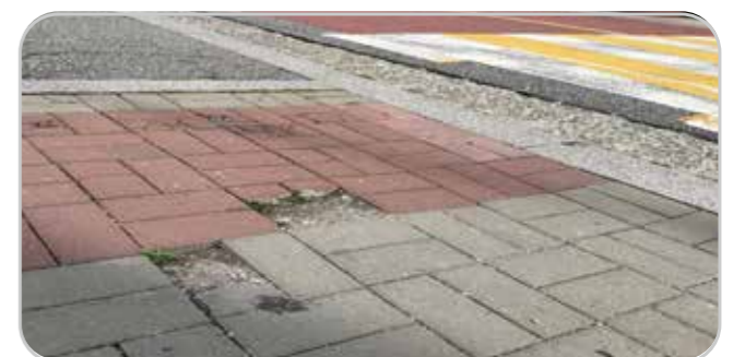
어린이보호구역 보도블럭 파손
