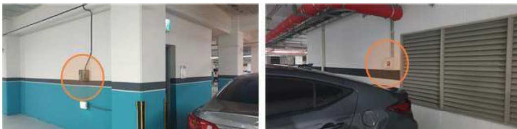
〈그림 40〉 출입구 근처에 설치된 수동스위치(좌), 차량 뒤에 설치된 수동스위치(우)
