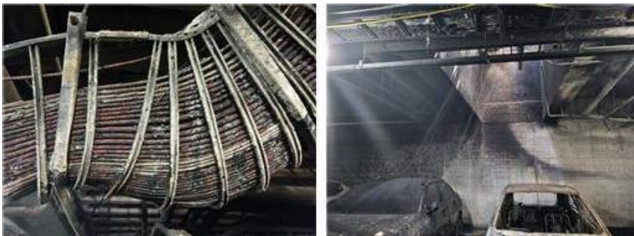
〈그림 6〉 케이블 트레이 훼손 및 자연환기구를 통한 열기 배출로 좌측 차량의 경우 소실되지 않은 사례(출처 : 소방방재신문)
