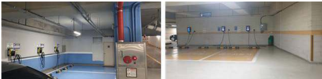
〈그림 39〉 화재감지기가 설치되지 않은 전기차 충전구역
