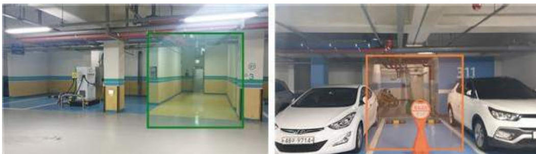
〈그림 32〉 주동 출입구 옆에 설치된 충전구역(좌), 주동 출입구 앞에 위치한 주차공간(우)
